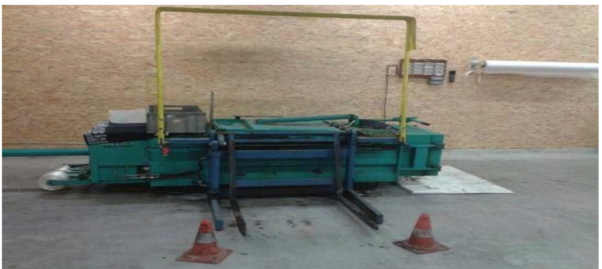
Εικόνα 5.8: Χώρος αποθήκευσης – συμπίεσης μικρών ανακυκλώσιμων αποβλήτων
